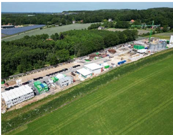
Bild 6.6 Auslaufbereich – Tagesanlagen der Vortriebsphase Quelle: RAG AG
