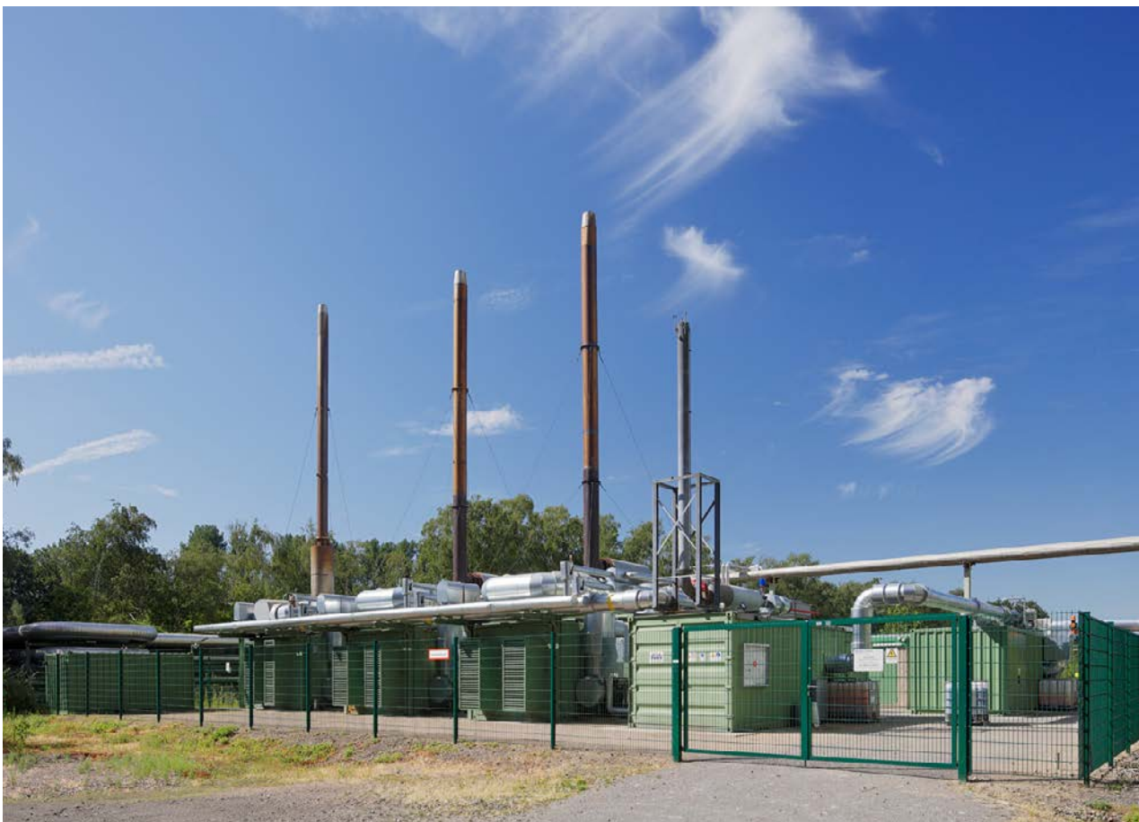
Bild 2.2 Grubengasverwertungsanlage Quelle: Friedhelm Krischer
