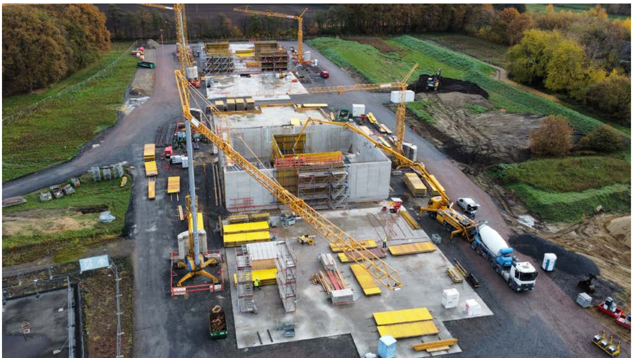
Bild 5.4 Grubenwasseraufbereitungsanlage Haus Aden Quelle: RAG AG
