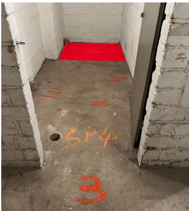
Bild 12.2 – Lokalisierter Schachtkopfbereich (rot) in einem der Einzelkellerräume (Quelle: Bezirksregierung Arnsberg)
