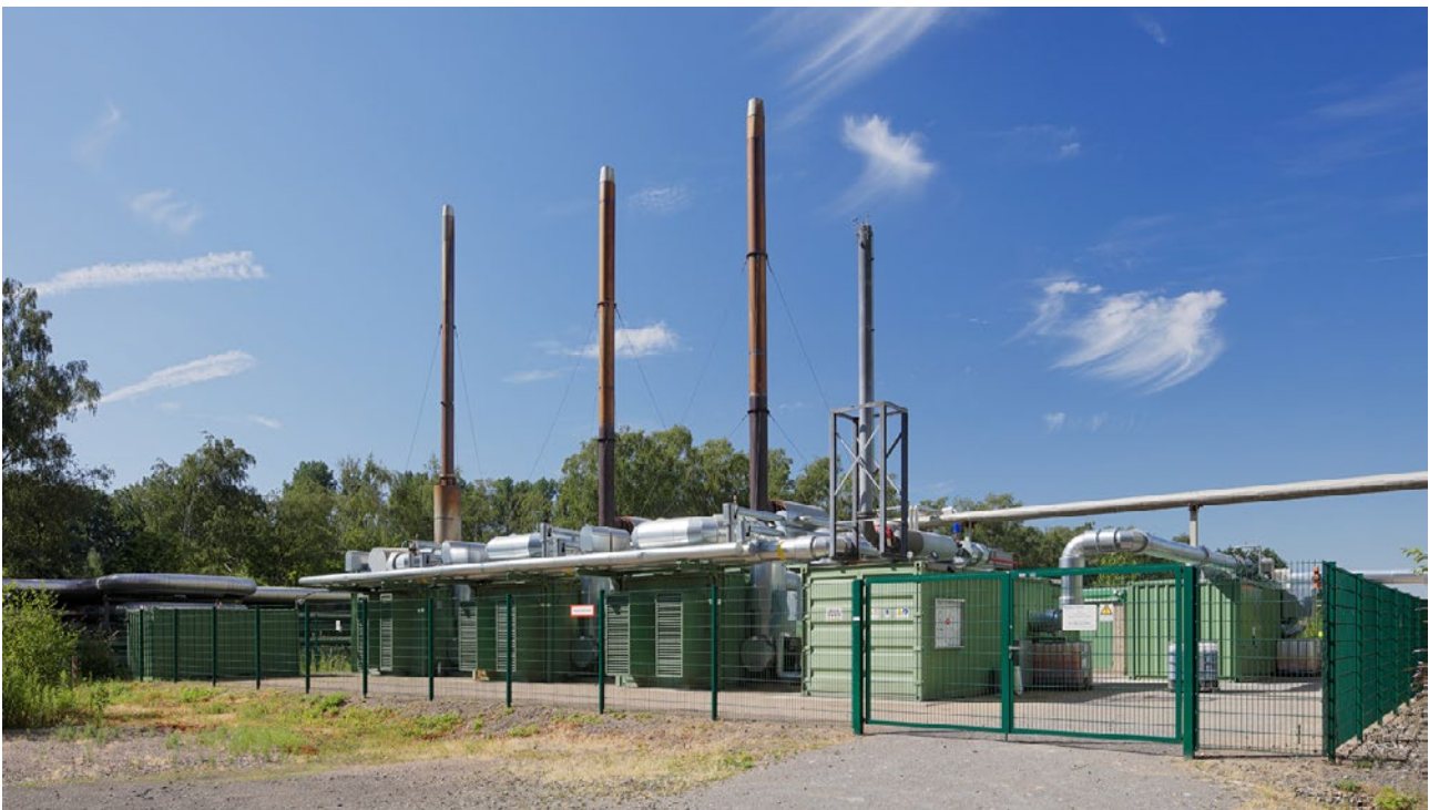
Bild 2.2 – Grubengasverwertungsanlage (Quelle: Friedhelm Krischer)
