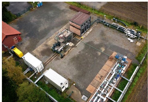
Bild 8.7 – Flutungsanlage auf dem Kavernenplatz (Quelle: RWE Gas Storage West GmbH)
