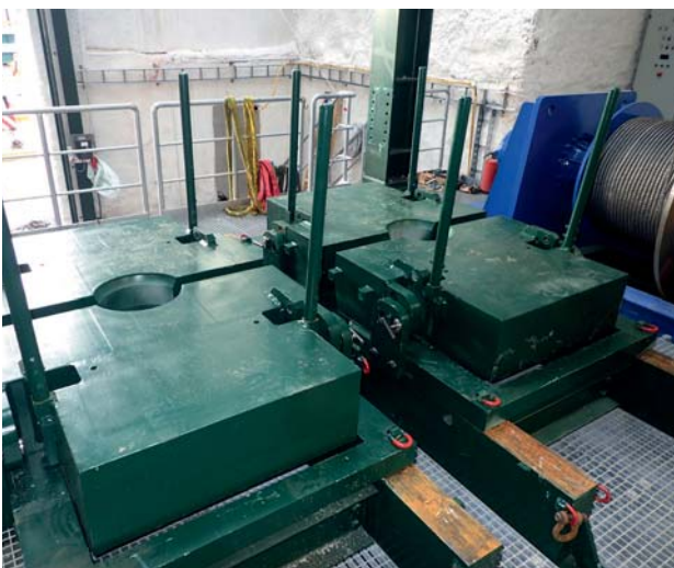
Bild 8.5 – Montagebühne, Montageklappe und Antriebswinde (Quelle: RAG Deutsche Steinkohle)
