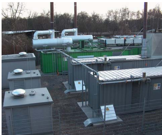
Bild 1.1 – Grubengasverwertungsanlage (Quelle: BR Arnsberg)
