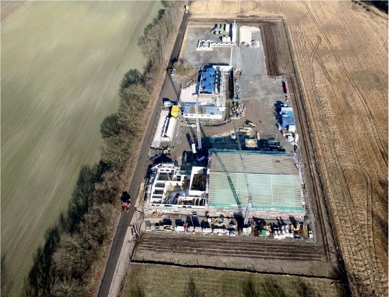
Bild 5.4 – Luftbild Helium-Untergroundspeicher Epe (Quelle: Textoris – Air Liquide)
