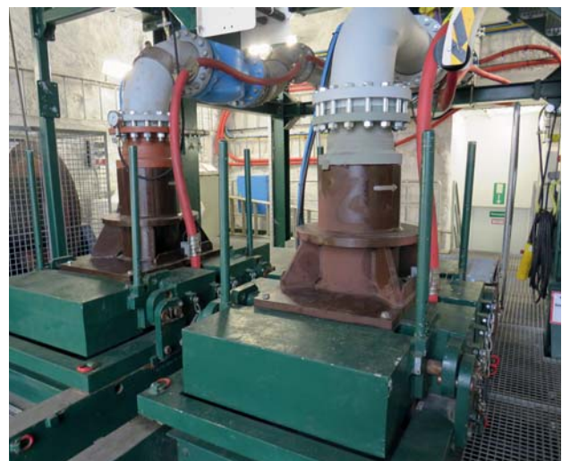
Bild 8.8 – Anschluss an übertägige Grubenwasserableitung (Quelle: RAG Deutsche Steinkohle)
