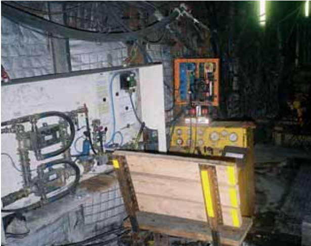
Bild 11.6 – Steuerstand mit Überwachungseinrichtungen für Wasser und Druckluft (linker Bereich) sowie Warneinrichtungen (mittig)
